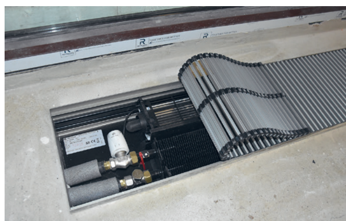
Внутрипольные конвекторы с принудительной конвекцией смонтированы под панорамными стёклами
