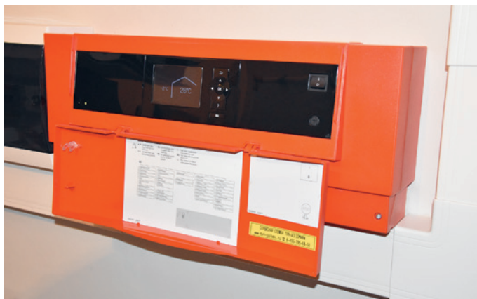
Контроллер Viessmann Vitotronic 200-H тип НКЗВ, установленный на стене котельной, подключён к контроллеру котла и вместе с ним образует единую систему управления отоплением
