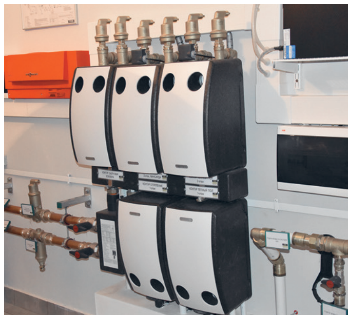
Распределительный узел системы отопления
