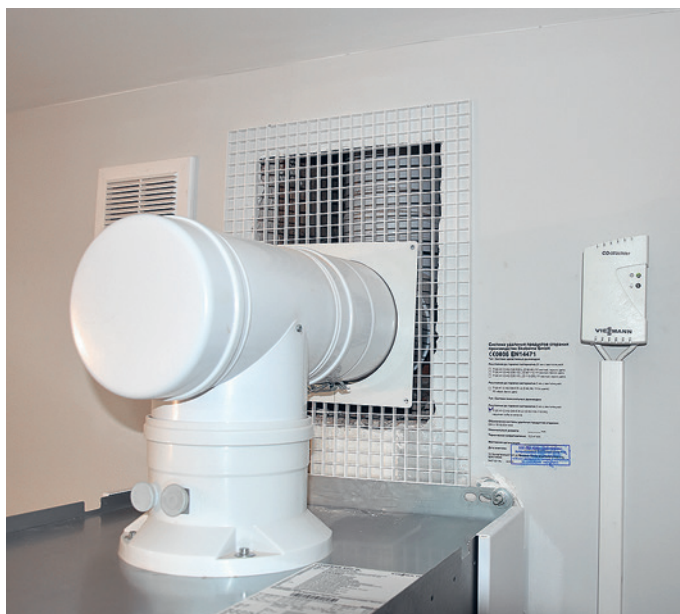
Дымоход котла. Справа — датчик загазованности
