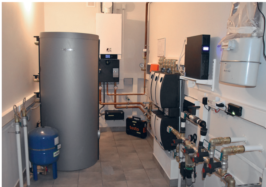
Котельная в доме
