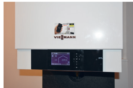
Контроллер Viessmann Vitotronic 200 min H01B, встроенный в настенный газовый конденсационный котёл Vitodens 200-W
